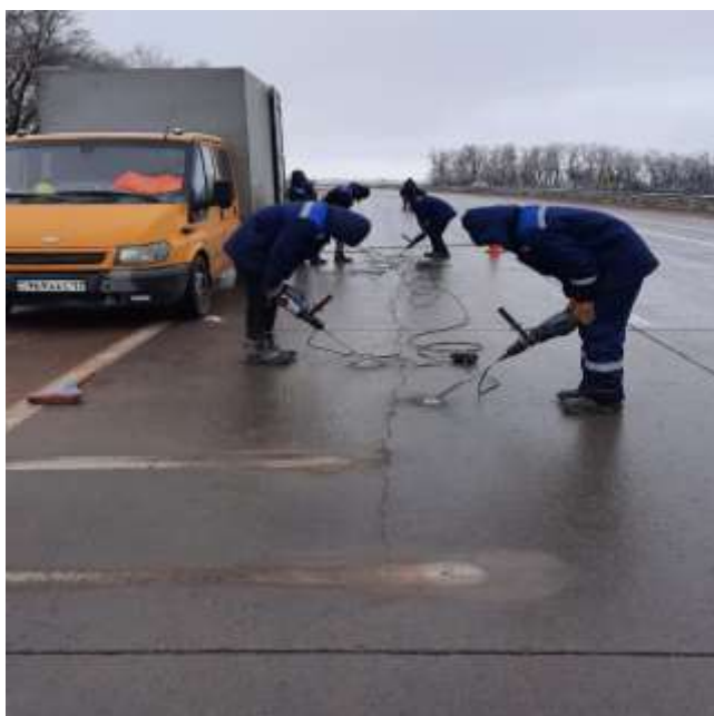
Рисунок 6. Устройство перекрёстного анкерования продольной трещины (опытный участок) [собственный материал]
