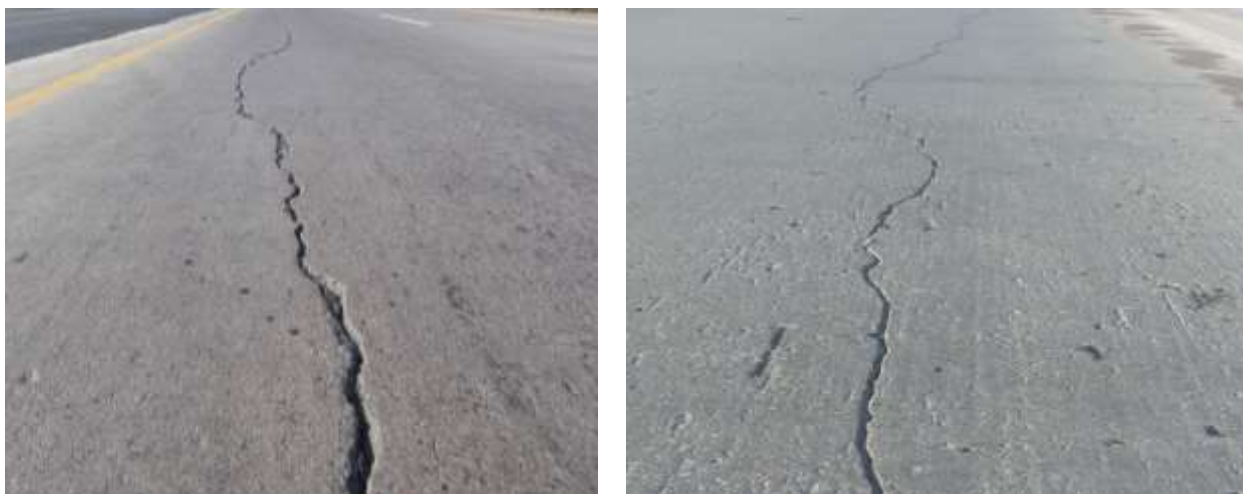
Рисунок 3. Сквозные продольные трещины в монолитном цементобетонном покрытии [собственный материал]
