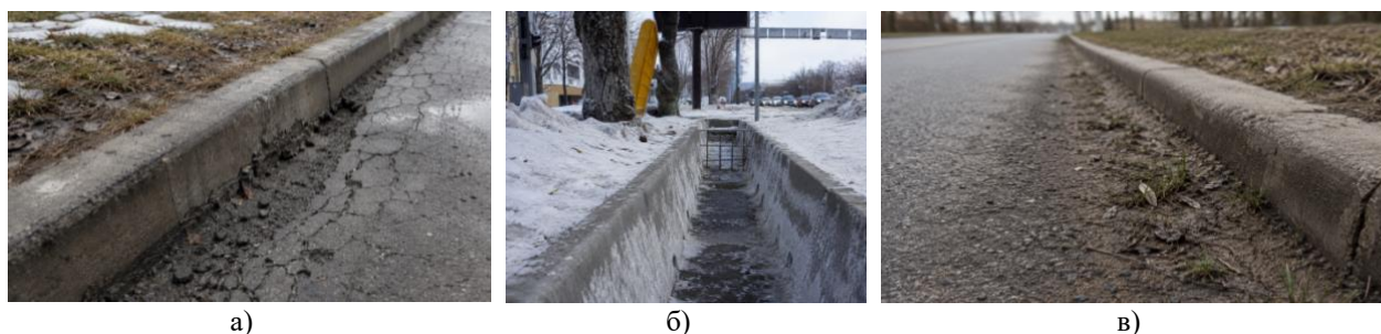
Рисунок 2. Повреждения кромки покрытия и элементов обустройства в прибордюрной зоне УДС г. Алматы: а - выкрашивание асфальтобетона (стриппинг); б - солевой налёт на стенках лотка; в - слежавшийся конгломерат у основания бордюра [материалы автора].
