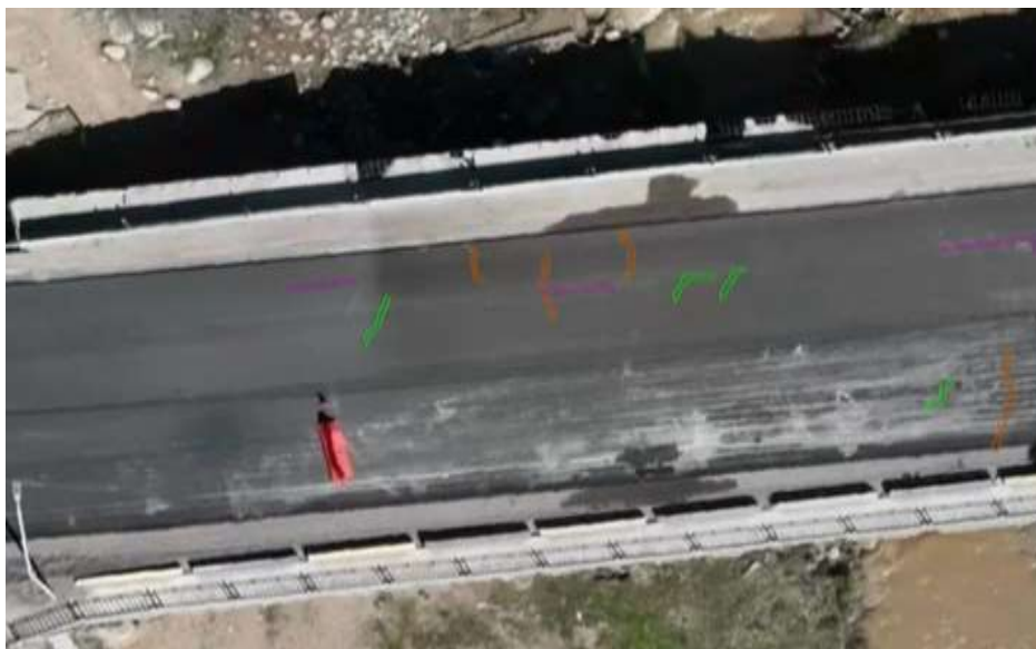
Рисунок 7. Пример фиксации дефектов покрытия и износа дорожной разметки на обследуемом участке [материал автора]
